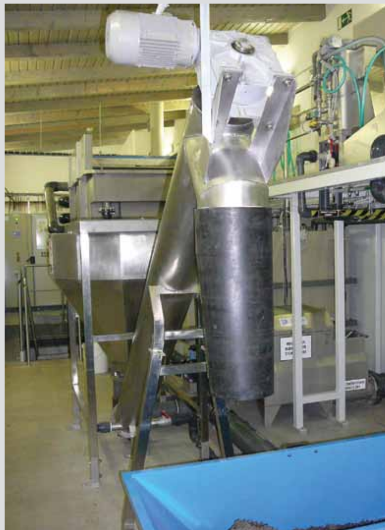
▼ Obr. 15. Technologická část čistírny mourových vod
