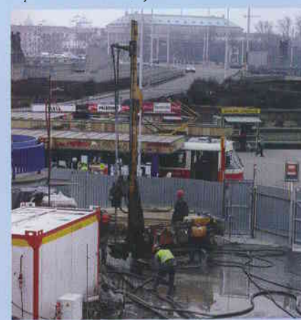
Obr. 3: Stanice metra Vltavská – provádění sloupů tryskové injektáže, vytvářejících základ pro zakotvení prvků mobilní ochrany
